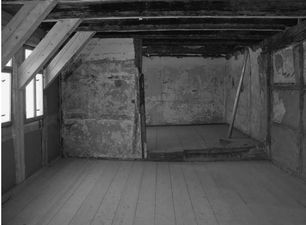
12 Bad Langensalza, Bergstr. 15. Saal im Obergeschoß, Ergänzung der aufgeblatteten Kopfbänder; rechts in Teilen freigelegte Farbfassungen aus dem 16. Jh. – Bad Langensalza, 15 Bergstrasse: les liens de tête reconstruits dans la grande salle du premier étage; à droite, peinture du XVIe siècle.
