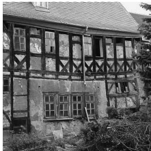
7 Bad Langensalza, Bergstr. 15, südliche Außenwand. Nach starken Bauschäden wurde das ursprünglich massive Erdgeschoß durch Fachwerk ersetzt. Die ehemals wohl auskragende Bohlenstube wurde 1694 im Außenbereich verputzt und im Innenbereich zeitgenössisch umgebaut. – Bad Langensalza, 15 Bergstrasse, façade sud. Le rez-de-chaussée, construit en pierre à l'origine, fut remplacé par une construction à colombages. La grande pièce à éléments lambrissés (peut-être en encorbellement) fut transformée à l'intérieur et crépie à l'extérieur en 1694.
