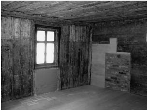
11 Bad Langensalza, Bergstr. 15. Bohlenstube, bauzeitliche Mischkonstruktion aus Stabbohlen- und Blockbohlenbau, 1515(d). Die Stabbohlen des Außenbereiches sind tragend konzipiert. – Bad Langensalza, 15 Bergstrasse: une combinaison de construction en madriers et en planches, datée de 1515 (dendr.).
