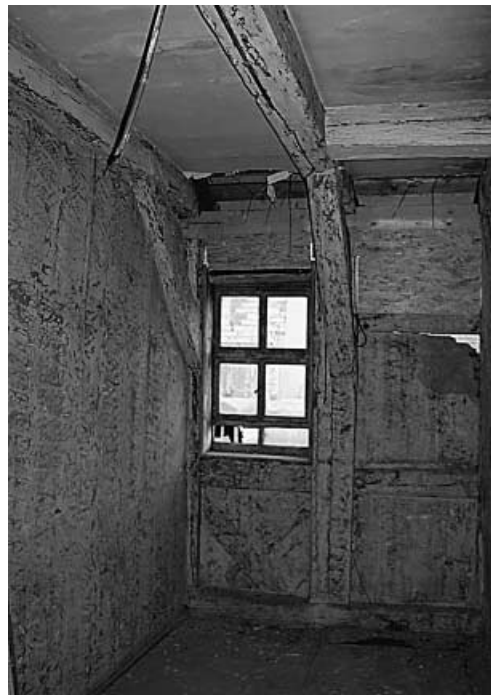
10 Bad Langensalza, Bergstr. 15. Raumaufteilung der frühen Phase im Westteil des 1. OG. – Bad Langensalza, 15 Bergstrasse: l'agencement d'origine de la partie ouest du premier étage.
